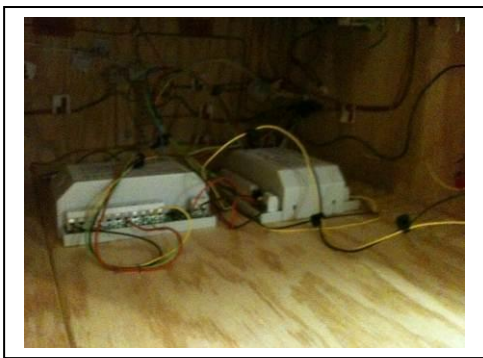
Die beiden verkabelten LDT - Decoder auf der Decoderklappe
